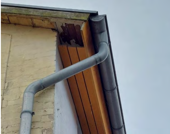
Abb. 3-2 Aus dem Dachkasten des Nebengebäudes der ehemaligen Versicherung heraushängendes Nestmaterial – Dohle (Foto: S. Bock, Datum: 10.02.2022).
