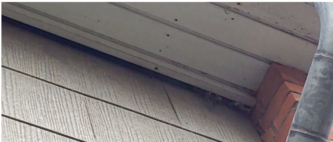
Abb. 3-3 Aus dem Dachkasten des Nebengebäudes der ehemaligen Versicherung heraushängendes Nestmaterial - Haussperling (Foto: K. Levermann, Datum: 10.11.2021).
